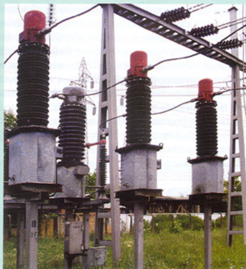
Рис. 1. Трансформаторы тока типа ТРЕ 11-С (на переднем плане) и напряжения типа УН 11-15 в ОРУ 110 кВ
